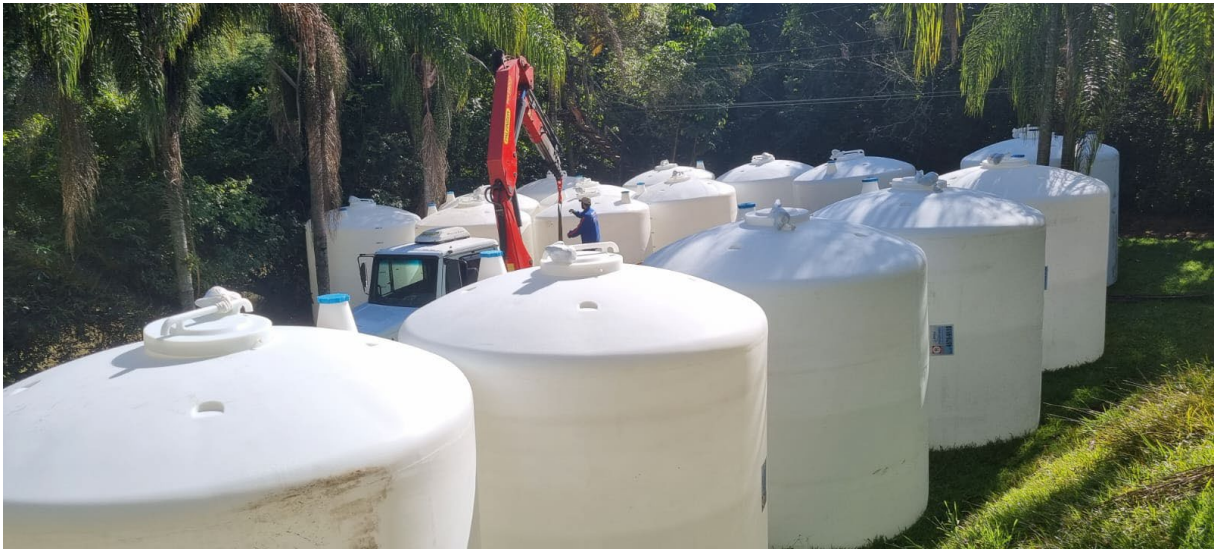
Figura 6 Tanques para armazenamento de produtos químicos
